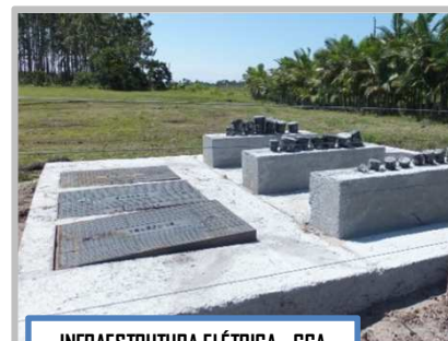
INFRAESTRUTURA ELÉTRICA - CCA
